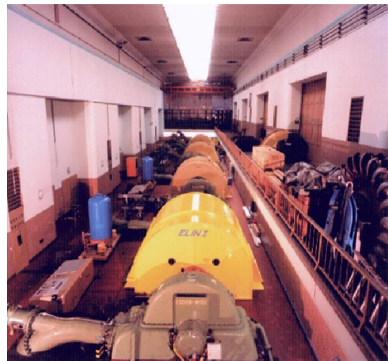
Bild 1.1-2: Pumpspeicher-Wasserkraftgenerator (Quelle: Kaprun/Tauernkraftwerke, ELIN )
