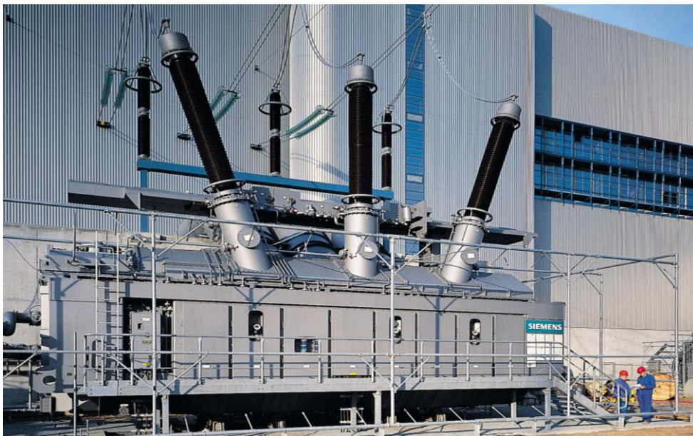
Bild T3.4-6: Blocktransformator 800 MVA, 27 kV / 380 kV im Braunkohle-Kraftwerk Schwarze Pumpe, Deutschland . Hinten oben das lange Ölausdehnungsgefäß. Ölkühler außerhalb des Bilds (Quelle: Siemens AG ).
