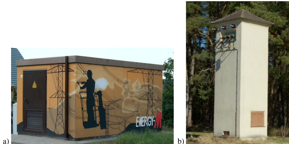
Bild T3.4-10: Eingehauste Verteiltransformatorenstation: a) Bernburg/Saale, D: Umspannen von z. B. 20 kV-Kabel auf 400 V-Kabel, b) Turmtransformatorstation bei Jakobsruh, D: Umspannen von z. B. 20 kV-Freileitung auf 400 V-Kabel (Quelle: Wikipedia.de ).
