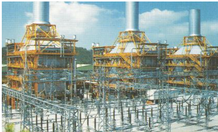
Bild P3.5.3-2: GuD (Gas und Dampf)-Kraftwerk Tapada do Outeiro, Portugal , Einwellenanordnung, drei Blöcke zu je 333 MW = 1000 MW el mit den drei Abgassloten und der luftisolierten Freiluft-Schaltanlage im Vordergrund (Quelle: Siemens AG).
