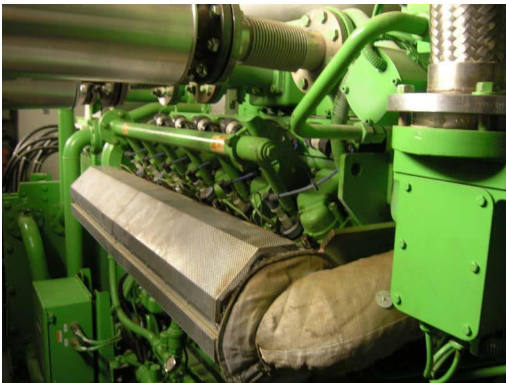
Bild P2.5-5: 12-Zylinder-Verbrennungskraftmotor mit 2 x 6 Zylindern in V-Anordnung als Antrieb für einen el. Synchrongenerator (im Hintergrund) in einem Biogas-Blockheizkraftwerk (BHKW), Güssing, Österreich (Quelle: Wikipedia.de ).
