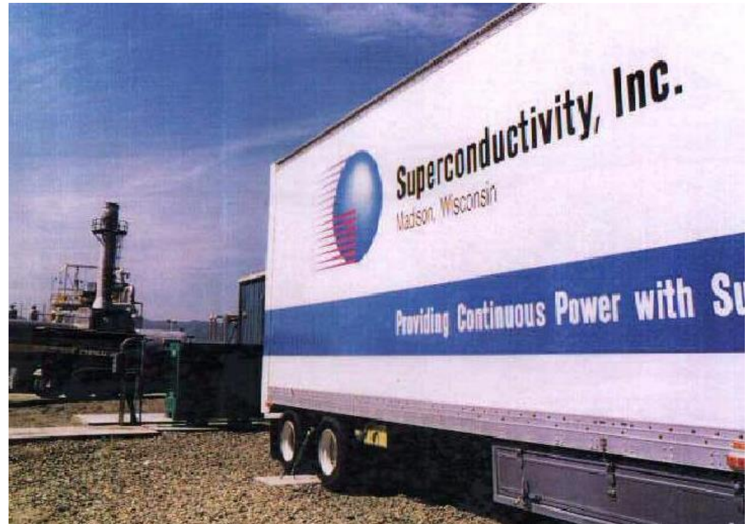
Installation des kompletten SMES ( S upraleitender m agnetischer E nergiespeicher) im Container
