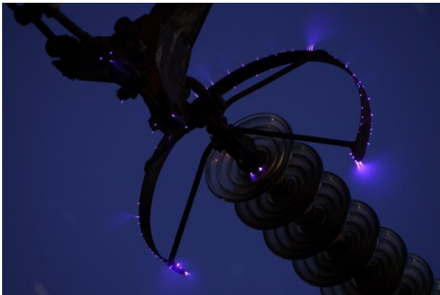
Korona-Entladung bei 500 kV-Freileitung an der Steuerelektrode
